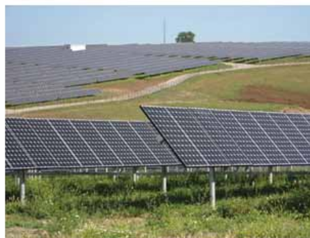
Serpa Solar Power Plant, Португалия
